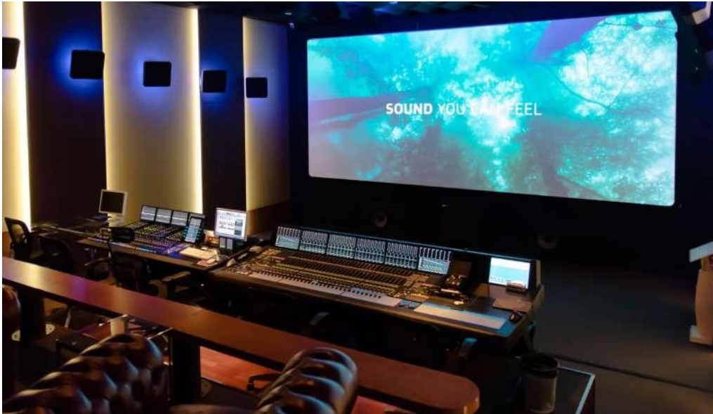
Ilustración 100. Sala de mezcla de Best Digital, Boadilla del Monte, Madrid.
