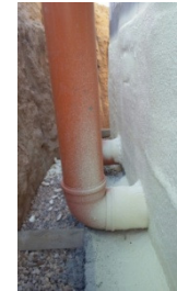
Fotografía nº 6 Salida de conductos de geotermia tierra-aire.
